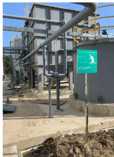
废水处理设施排口及标识牌
