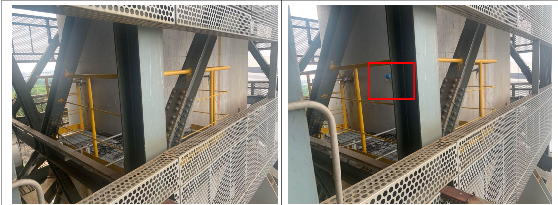
SCC 温度计改造前
